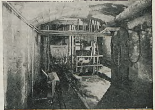
Rys. 6. Widok stacji załadawczej.
