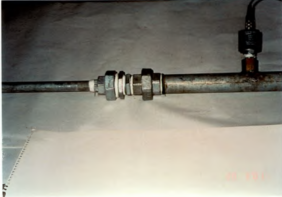
Rys. 4.9. Połączenie rur stalowych o różnych średnicach oraz czujniki tensometryczne zamontowane na odcinku zmiany średnic.
