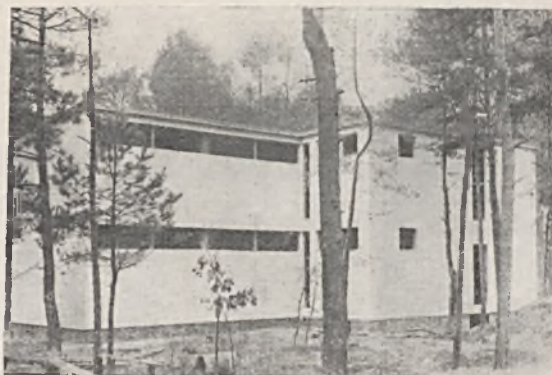
Ryc. 14. Widok ścian z okładziną z kamienia pińczowskiego po ocyklinowaniu licówki. Budowa d-ra B. w Konstancinie.
