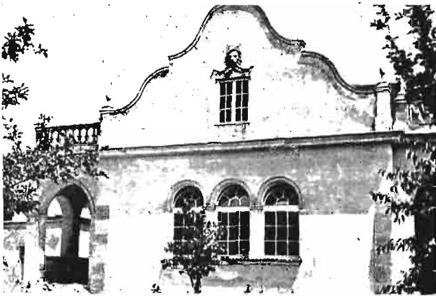
Fot. 20. Wyprawa niszczona przez deszcz i wiatr.
