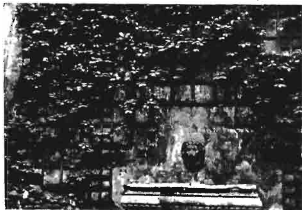
Fot. 9. Wpływ roślinności na wyprawę.
