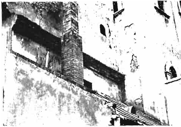
Fot. 7. Wpływ gazów komin. na wyprawę.
