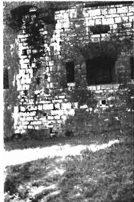
Fot. 10. Roślinność na wyprawie i zaprawie.
