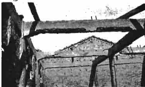
Fot. 2. Belki dwuprzęsłowe po pożarze.
