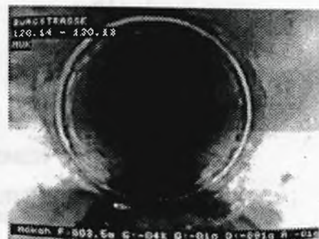
Rys. 15 Uszkodzone złącze + pęknięcia podłużne
