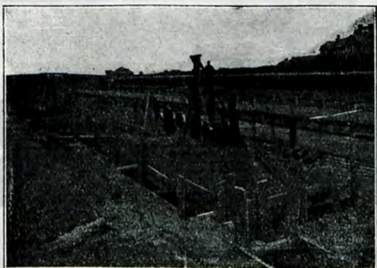
Budowa Rzeźni miejskiej w Moskwie. Wykonanie fundamentów palowych syst. „Sterna“ pod Stacją Biologiczną. 7
