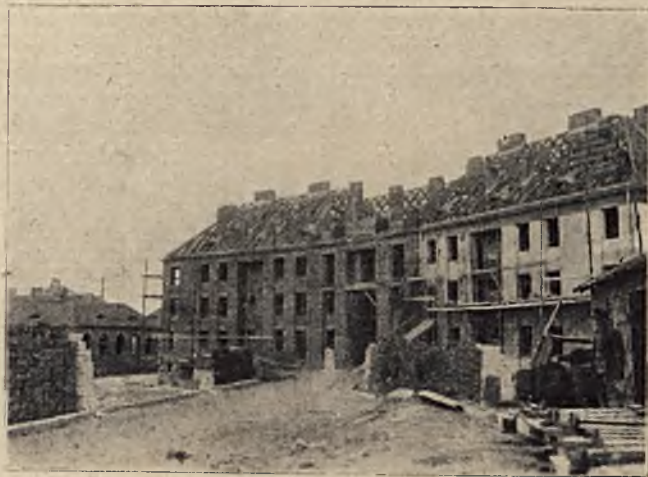
OKSYWJA pod Gdynią. Zespoły domów podoficerskich. Roboty wykonywa przy pomocy ruchomych rusztowań murarskich firma „Żelazo - Beton”.
