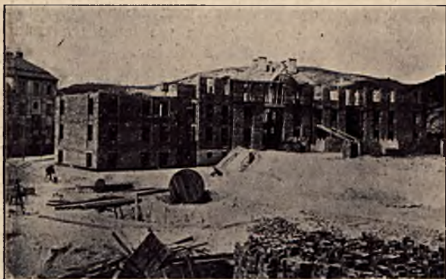
OKSYWJA. Budowa domów mieszkalnych marynarki wojennej. Wykonywa przy pomocy rusztowań ruchomych firma „Żelazo-Beton”.
