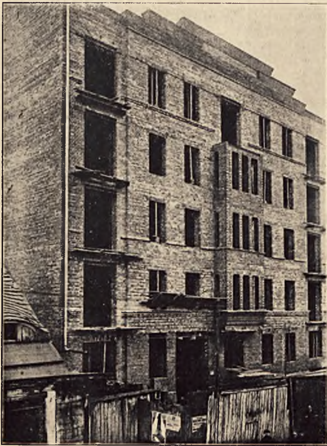
ŁÓDŹ. Budowa domu mieszkalnego i-my I. Fuks i S-ka przy ul. Pomorskiej 41 a. Budowę wykonywa przeds. bud. I. Tyller.
