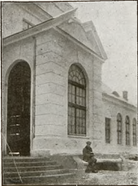
SŁONIM. Fragment dworca kolejowego. (budow. inż. W. Dziewulski i K. Korybut Daszkiewicz w Warszawie.)
