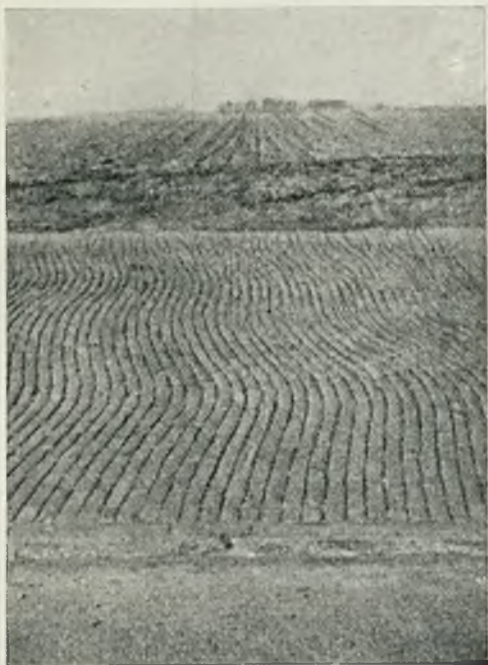
Fot. 9. Stara nawierzchnia klinkierowa, zdeformowana pod wpływem ruchu.
