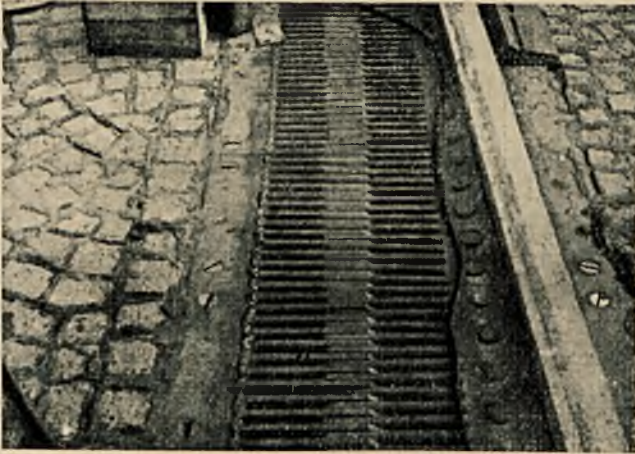
Rys. 39. Autostrada Norymberga — Lipsk. Kostka zalana asfaltem i dylatacja w jezdni
