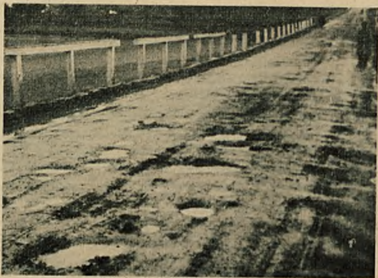
Rys. 7. Stan nawierzchni na km 327'38 — 330'09 traktu Nr 13.
