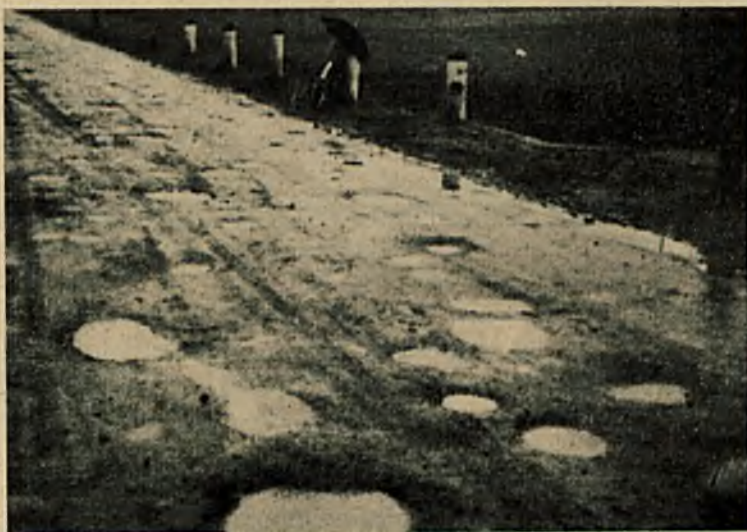
Rys. 2. Stan nawierzchni na km 316'64 — 319'19 traktu Nr 13.
