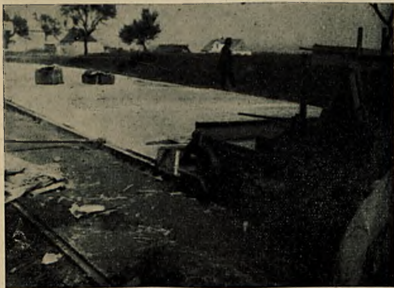
Ryc. 5. Budowa nawierzchni betonowej na drodze państwowej Praga — Berno w r. 1929 (firma Kottland).
