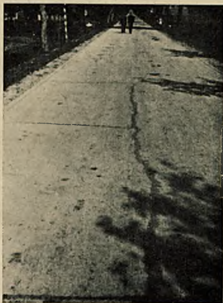
Rys. 4 Najpierw pęknięcie podłużne następnie poprzeczne. Także w tym wypadku następuje zazwyczaj wielokrotne pęknięcie płyty.
