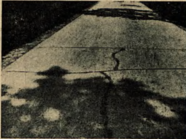
Rys. 5. Najpierw pęknięcia poprzeczne następnie podłużne. Tutaj następuje zazwyczaj dalsze pęknięcie płyty a mianowicie w miejscu gdzie cztery naroża się spotykają powstają rysy ukośne. Naroża płyt pękają w kształcie trójkątów.
