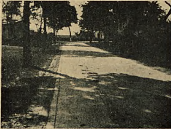
Rys. 2. Ta sama droga betonowa jak na rys. 1. Brak rys podłużnych gdyż korona drogi leży około 1.5 m ponad otaczającym ją terenem a pozatem istnieją dobrze odwadniające boczne rowy.
