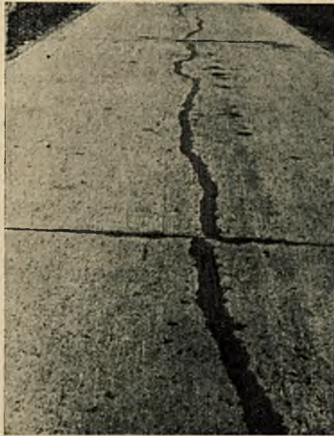
Rys. 1. Typowa rysa podłużna na drodze betonowej o szerokości 5 m, grubości płyty 15 cm w środku i 20 cm na brzegach. Przyczyna—złe odwodnienie podłoża.
