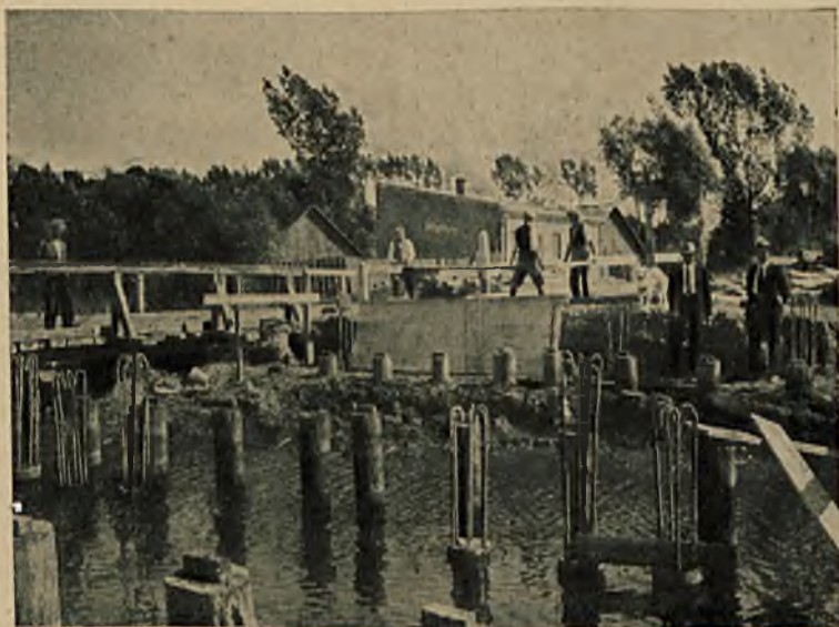
Rys. 2. White pale żelazobetonowe pod przyczółek i filar mostu w Tarczynie. Uzbrojenie pali wystaje.
