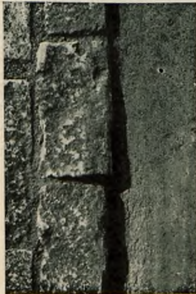
Rys. 21. Podwyższony krawężnik ponad jezdnię.
