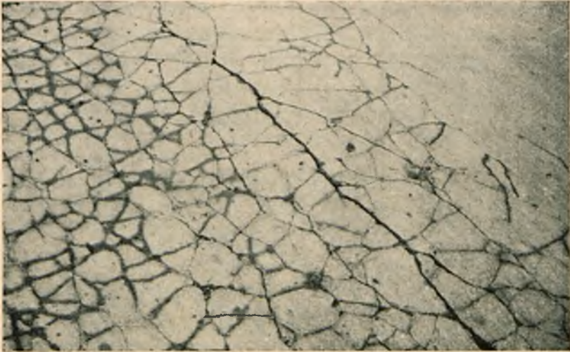
Rys. 4. Pęknięcie skośne do osi drogi i siatka pęknięć.
