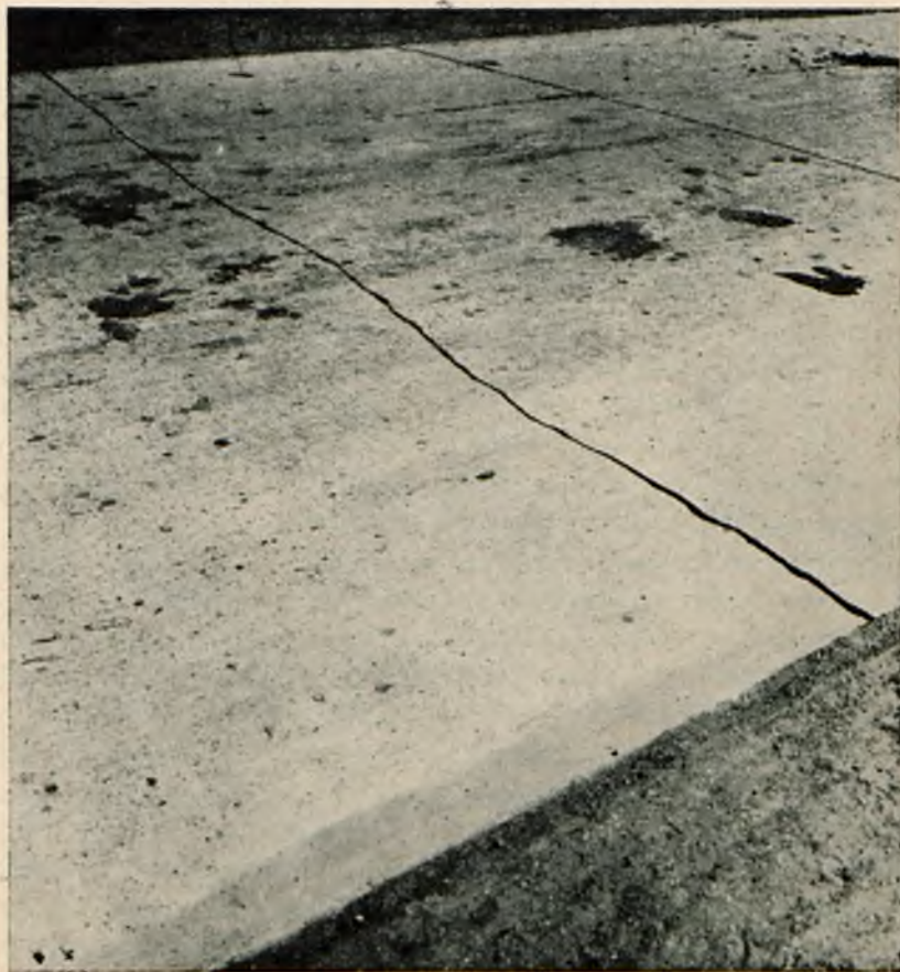
Rys. 2. Pęknięcie poprzeczne prostopadłe do osi drogi.
