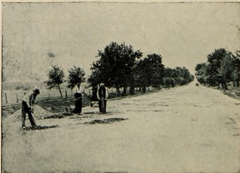
Rys. 2. Remont cząstkowy na 19 km. tr. Kowieńskiego. Intensywność ruchu 1416 tonn na dobę, w tem 525 tonn ruchu samochodowego. Nawierzchnia szabrowa już w dwa miesiące po kapitalnym remoncie uległa zniszczeniu.
