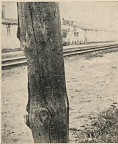
RYŚ. 24. SŁUP ZNISZCZONY PRZEZ SPUSZCZELĄ
