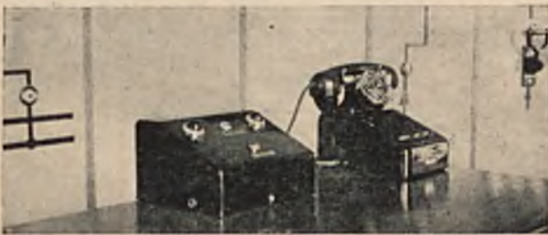
RYC. 7. SKRZYŃKA SYGNAŁOWA WRAZ Z APARATEM GŁÓWNYM NA STOLE DYŻURNEGO W NASTAWNI W MOŚCICACH.
