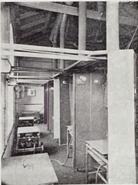
Rys. 2. Widok na stanowiska spawalnicze od strony wewnętrznej.
