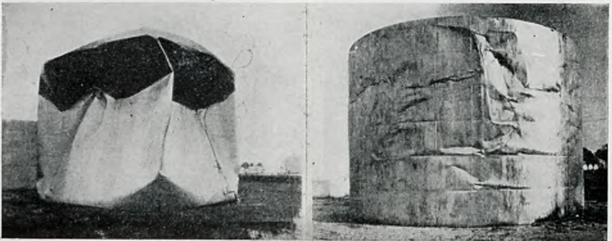
Rys. 13. Duży spawany zbiornik uszkodzony przez ciśnienie atmosferyczne. Zdjęcie z prawej strony przedstawia zbiornik już częściowo naprawiony.
