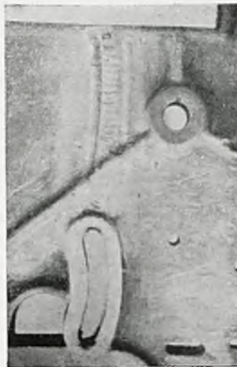
Rys. 14. Widok z bliska miejsca naprawionego ramy z rys. 13.
