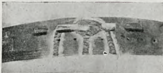
Rys. 7. Szczegół miejsca uszkodzonego po naprawie.
