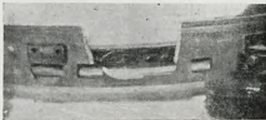
Rys. 6. Szczegół miejsca uszkodzonego przed naprawą.
