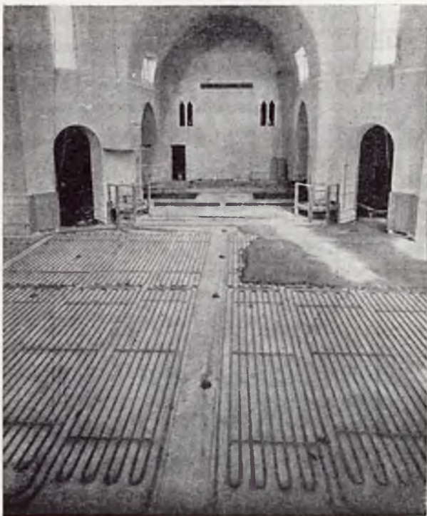
Rys. 2. Widok całości instalacji. W głębi na prawo — pokrywanie rur betonem; beton powinien być — o ile można — jak najmniej wilgotny.
