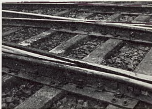
Rys. 1. Wyszczerbiona krzyżownica, która była naprawiana elektrycznie.
