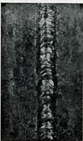
Rys. 4. Widok spoiny z rys. 3. od strony odwrotnej
