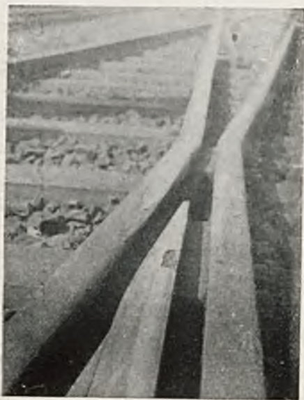
Rys. 4. Krzyżownica przed naprawą.
