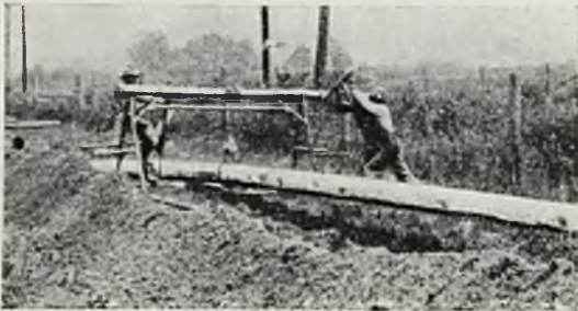
Rys. 136. Opuszczanie gotowego rurociągu do ziemi. w tym celu, aby w czasie ruchu nie okazały się przykre niespodzianki.
