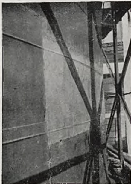
Rys. 3. Blachy nałożone na miejsce wyżarte.
