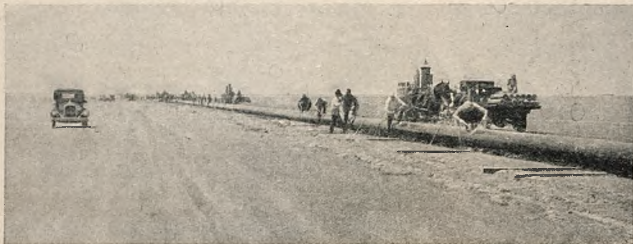
Rys. 21. Spawanie rurociągu odcinkami przez drużyny złożone z 5 spawaczy. W środku pomocnik obracający cały odcinek.
