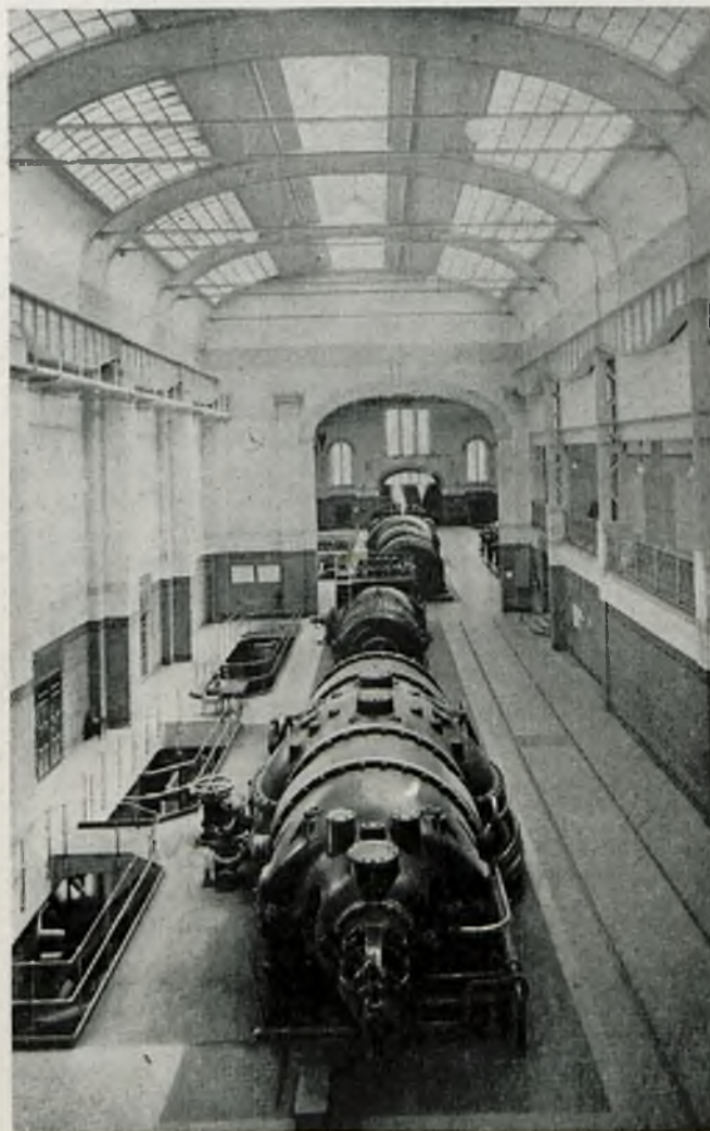
Rys. 7. Hala maszyn w elektrowni Värtaverket .
