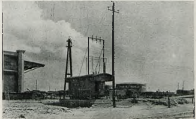
Rys. 3. Wóz transformatorowy ustawiony na nabrzeżu Stanów Zjednoczonych, o mocy 320 kVA.
