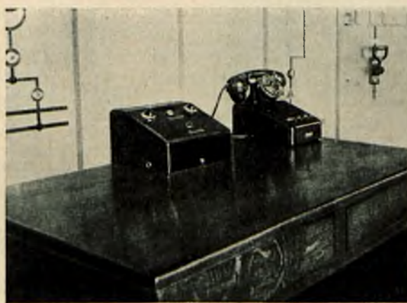
Rys. 14. Widok aparatów telefonicznych na stole dyżurnego ruchu w nastawni elektrowni w Mościcach.
