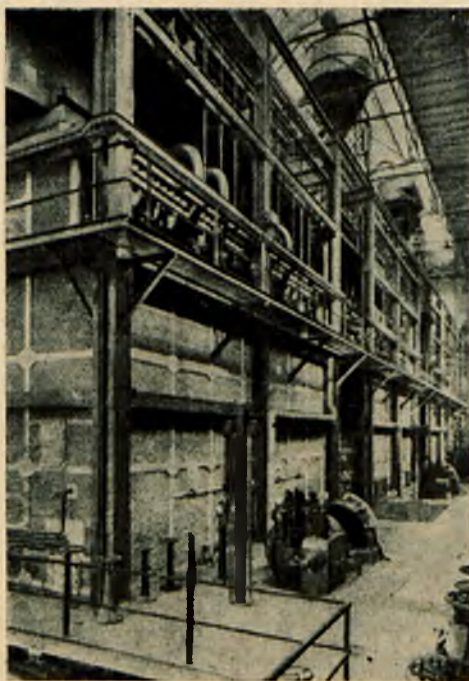
Rys. 23. Kocioł wysokiego ciśnienia (przed kotłem pompa obiegowa).
