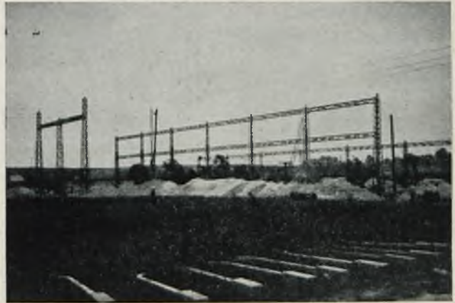
Rys. 28. Konstrukcje napowietrznej stacji transformatorowej.
