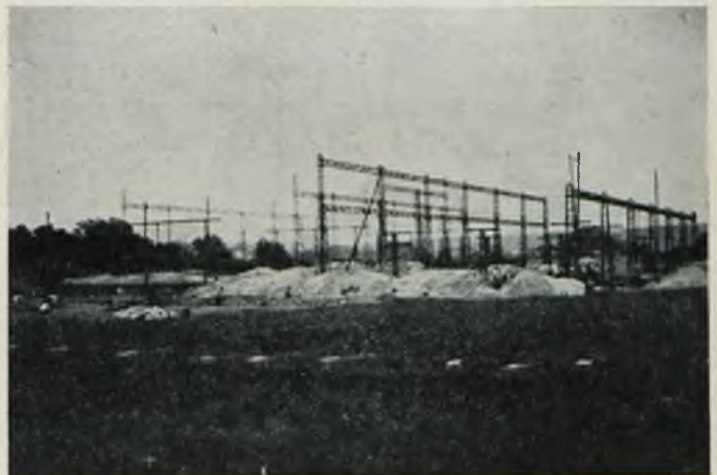
Rys. 29. Konstrukcje napowietrznej stacji transformatorowej.
