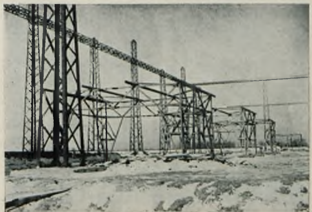
Rys. 30. Konstrukcje napowietrzne stacji transformatorowej.
