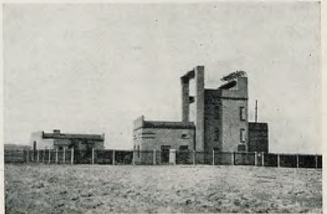
Podstacja 35 6 kV w Mijaczuwie.
