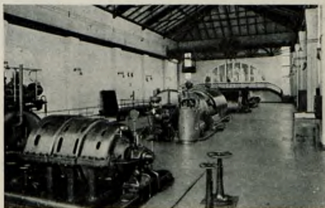
Hala maszyn w elektrowni kop. „Anna”.
