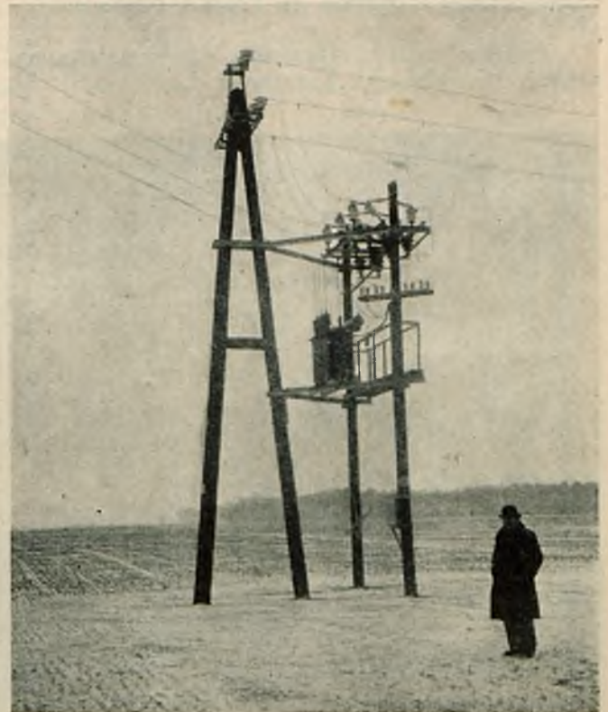
Stacja transformacyjna 30 000/380/220 V o mocy 50 kVA, zasilająca Zakład Psychiatryczny w pow. Gostynińskim.
