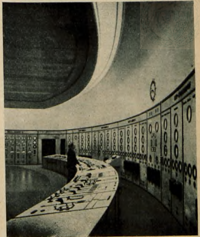
Rys. 13. Nastawnia elektrowni West.
