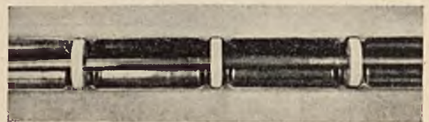
RYŚ. 3. WIDOK PRZEWODÓW I KRAŻKÓW IZOLACYJNYCH.
