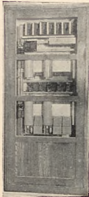
RYS. 15. ŁĄCZNICA PÓLAUTOMATYCZNA PA-50 W SZAFIE.
