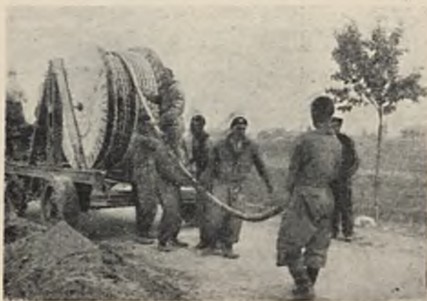
RYŚ. 4. WÓZ KABLOWY.
