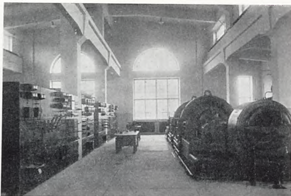
RYC. 1. WNĘTRZE CENTRALI NADAWCZEJ STACJI [TRANSATLANTYCKIEJ.
