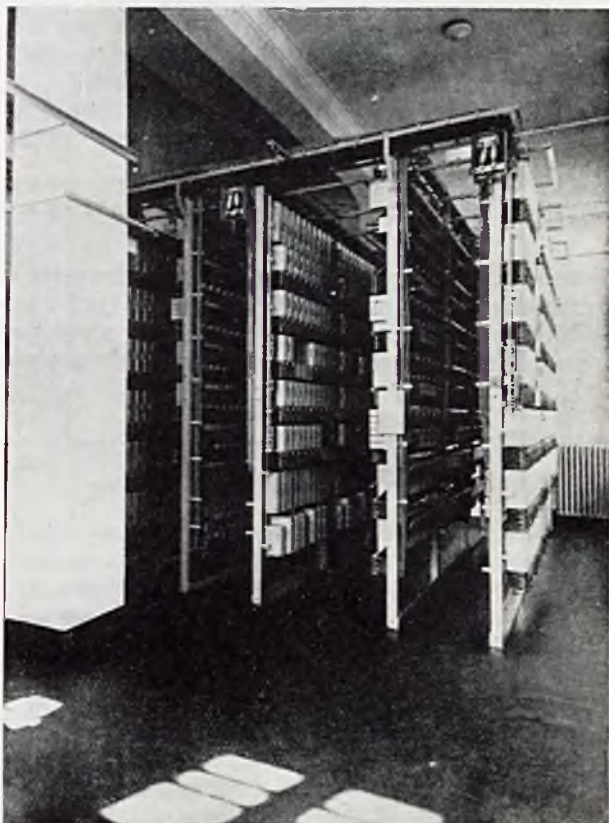
RYŚ. 6. WNĘTRZE CENTRALI AUTOMATYCZNEJ MIEJSKIEJ W GDYNI.
