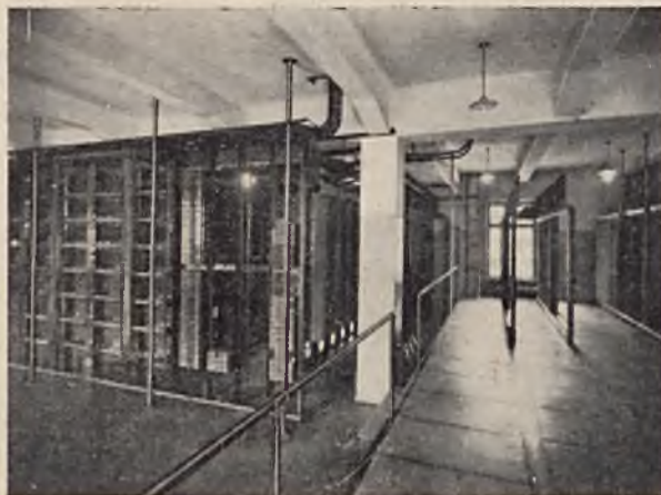
RYS. 6. SALA APARATOWA I PRZEŁĄCZALNIA WE LWOWIE.
