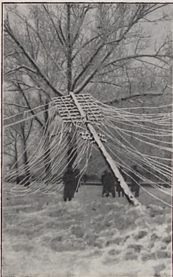
RYŚ. 1. LINJA MIĘDZYMIASTOWA ZNISZCZONA PRZEZ ŚNIEŻYCĘ.
