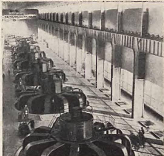
Rys. 383. Hala turbin hydro-centrali „Dnieproges”.
