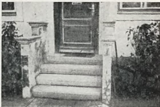
Rys. 423. Balustrada zniszczona wskutek pokrycia „ozdobnym” gzymsem zamiast izolacji.
