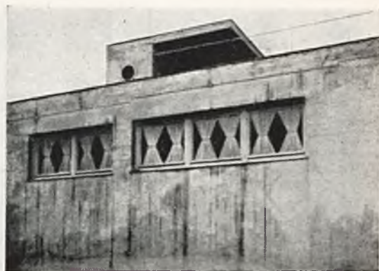
Rys. 424. Parapet „nowoczesny” zniszczony wskutek braku należytej izolacji.
