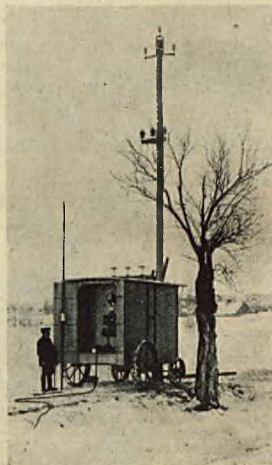
Rys. 7. Transformator przewoźny, przyłączony do linii 15 kV.
