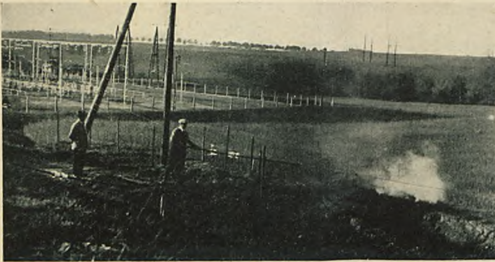
Rys. 1. Uziemienie leżącego na ziemi przewodu linii 60 000 woltów pod napięciem.
