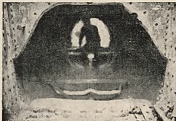
Rys. 1. Ściana sitowa po wycięciu sita.
