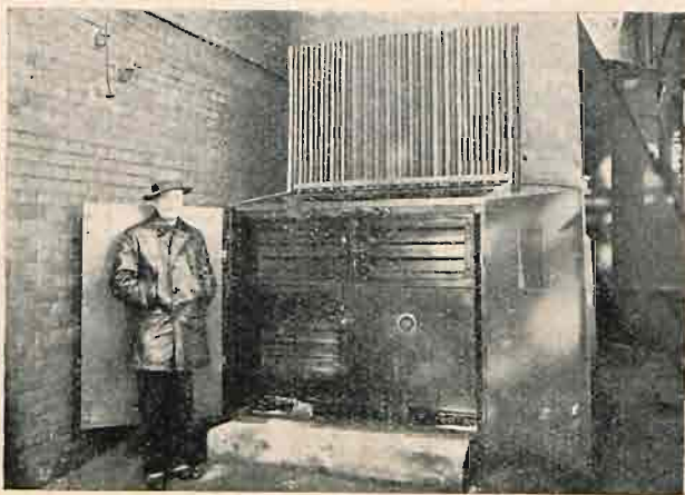
Rys. 1. Automacyjny regulator Aeosolo, zainstalowany u podnóża kominu w Gazowni Miejskiej w Bydgoszczy.
