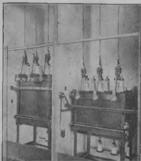
Rys. 119. Wyłączniki olejowe na prąd wysokiego napięcia w celkach.
