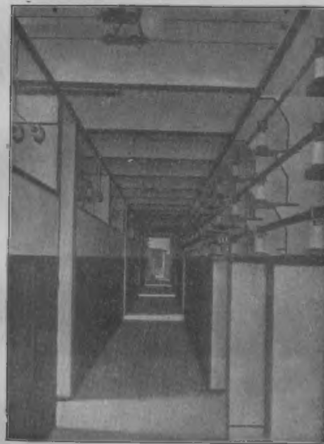
Rys. 118. Rozdzielnia elektrowni Warszawskiej. Prąd wysokiego napięcia 5000 woltów.
